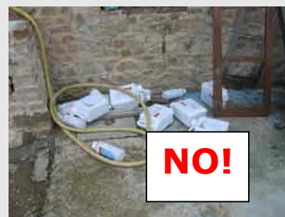
I contenitori vuoti rappresentano una fonte di inquinamento e di pericolo (Foto Cons. Fito. Parma)
