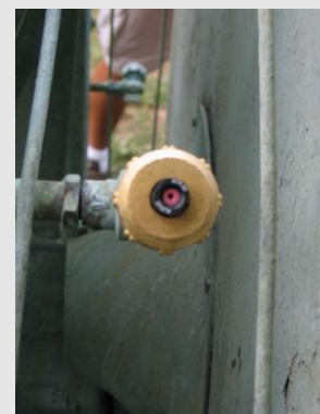
Ugello in buono stato di manutenzione (Foto Cons. Fito. Reggio Emilia)
